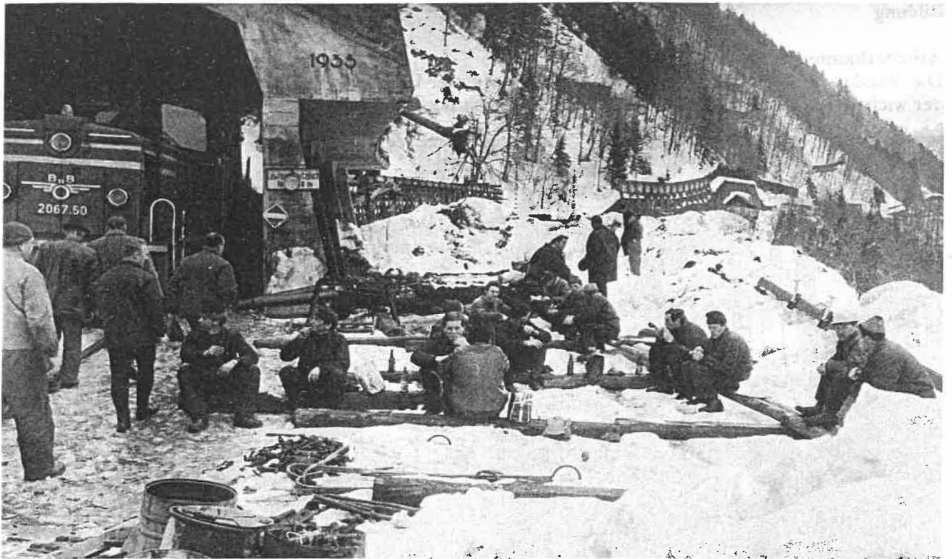
Die Schanatobelbrücke wurde von einer Lawine weggerissen. Die Arbeiter errichten eine Notbrücke für den Bahnverkehr (1968).
